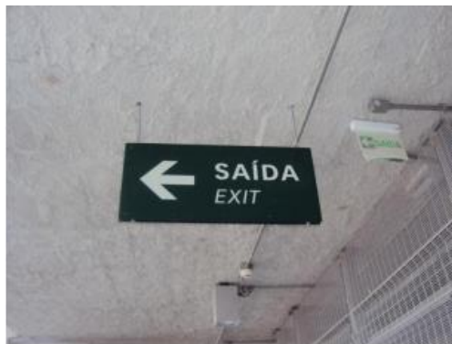
Figura n. 14: Placa de sinalização de emergência
