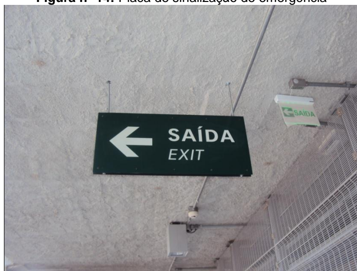
Figura nº 14: Placa de sinalização de emergência
