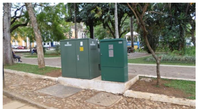
Rede de Distribuição Subterrânea
