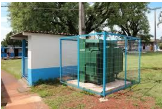
Transformador em pedestal
